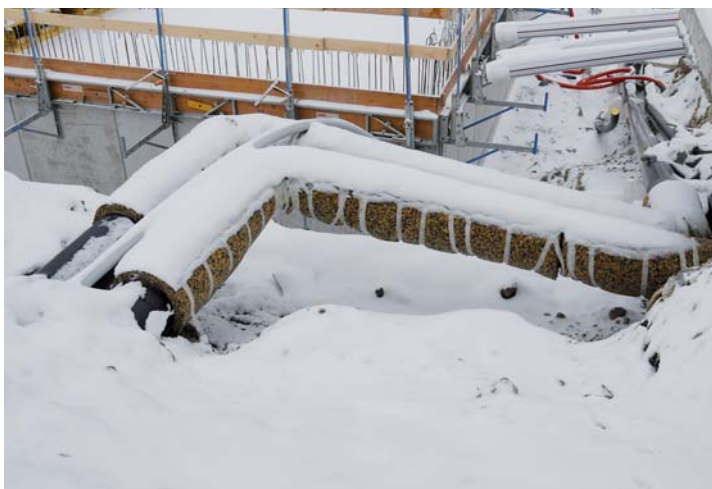
11. Januar 2010 Isolierte Rohre trotzen der Kälte.
