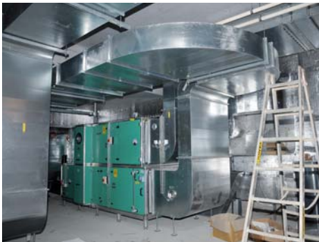
18. November 2010 Ein Blick in den Technikraum
